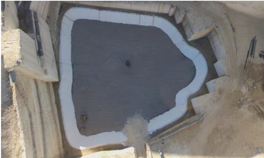
Bacino di fondo allestito per lo scarico dei rifiuti – Impianto Minervino Murge
